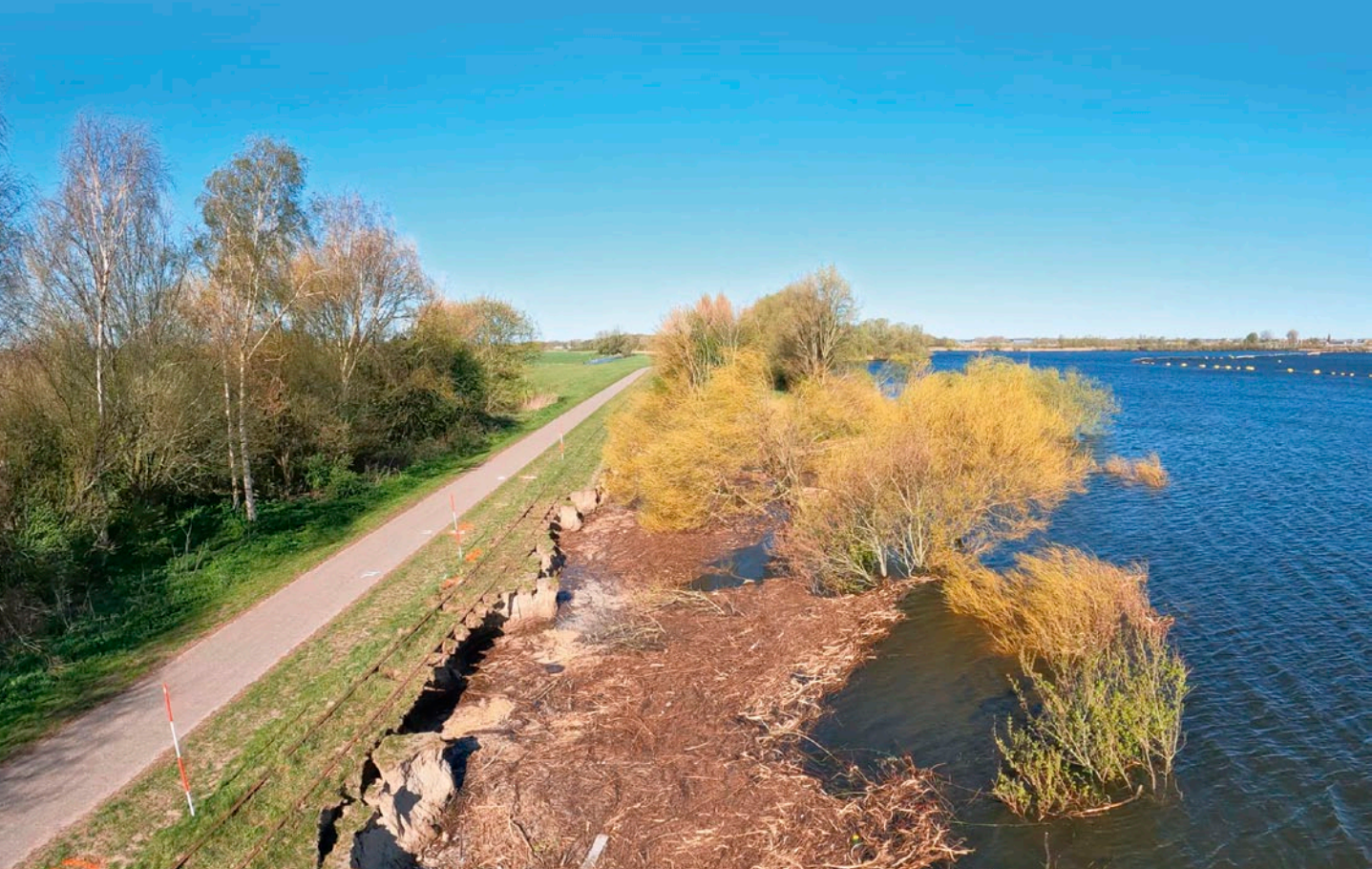
Hier is goed te zien dat de afkalving op sommige plaatsen tot onder onze spoorlijn loopt. Valkenburg, 6 april 2025. Foto: George Kroon jr.
