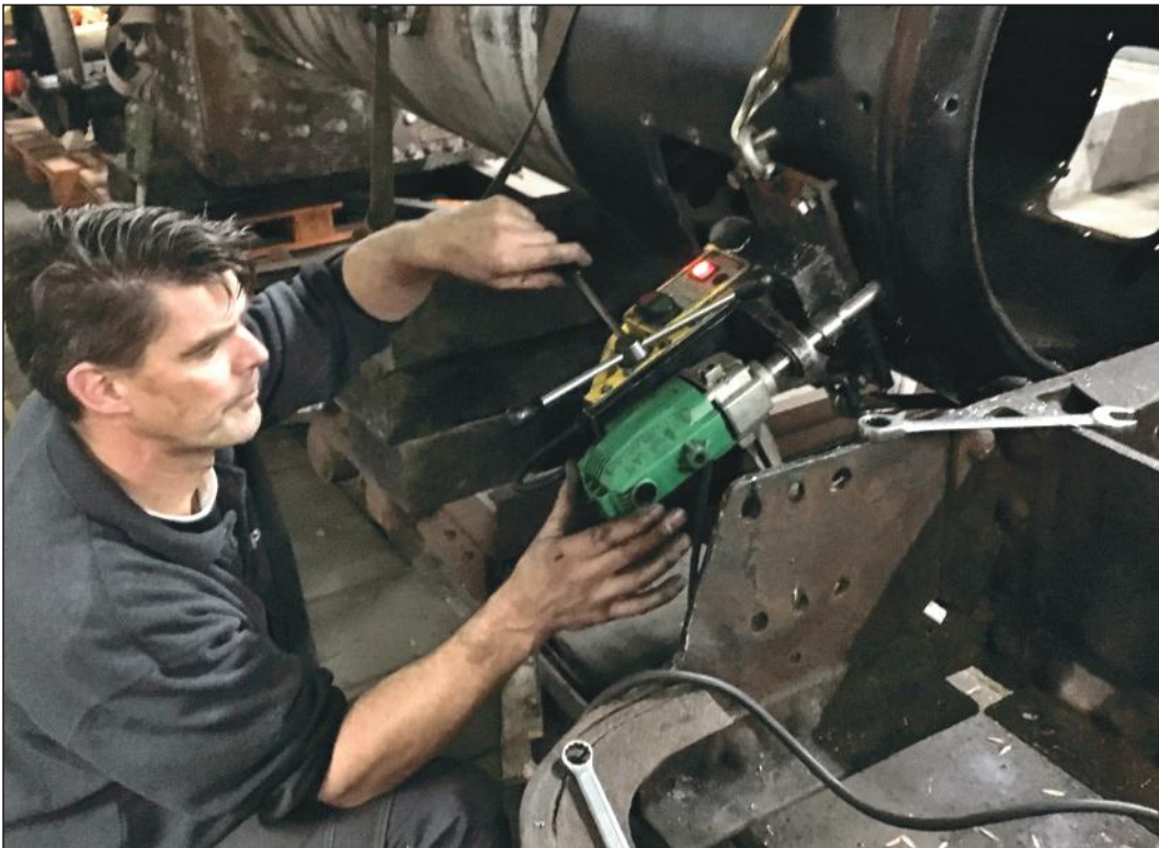
Herman Berkheij boort bij stoomloc 6 de klinknagels van de rookkast uit. Rookkast, rookkastdeur en schoorsteen worden hergebruikt.
